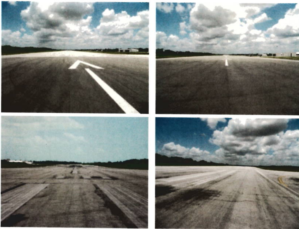
Pista. Izquierda arriba: centro de la pista y calle de rodaje y abajo cabecera 10. Derecha: Cabecera 28
